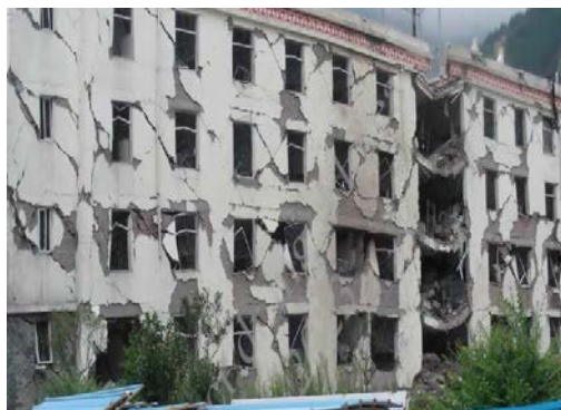
Fig. 9. Colapsul parțial unei clădiri
