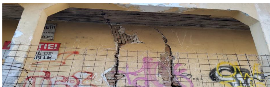
Fig. 11. Crăpături în pereții de zidărie
