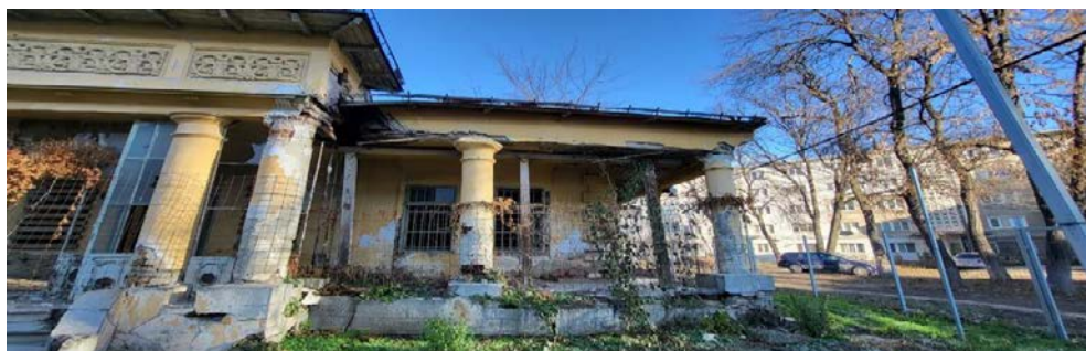
Fig. 13. Stâlpii circulari de la terasă înclinați, cu baza ruptă sau cu învelișul protector din zidărie de cărămidă distrus
