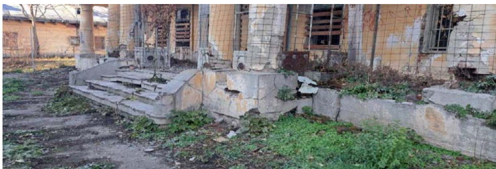
Fig. 6. Tasări la nivelul fundațiilor
