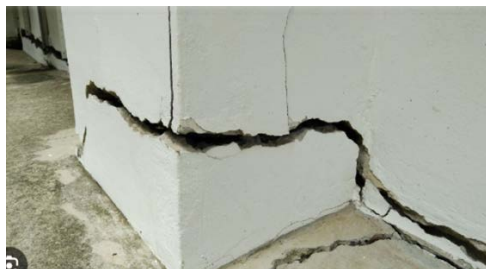
Fig. 7. Fisuri în perete și stâlp
