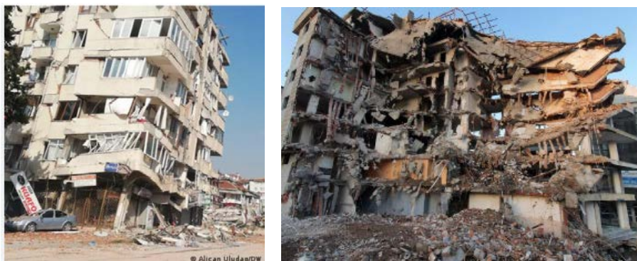
Fig. 7. Clădiri avariate de cutremur
