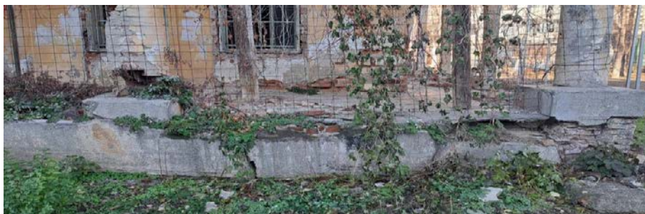
Fig. 7. Crăpături la nivelul fundațiilor
