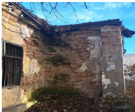
Fig. 8. Elemente de zidărie lipsă pe zone extinse
