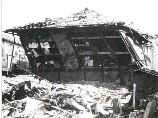
Fig. 10. Deformație ductilă a unei case tradiționale din cadre de lemn (cutremurul Kobe din 1995)
