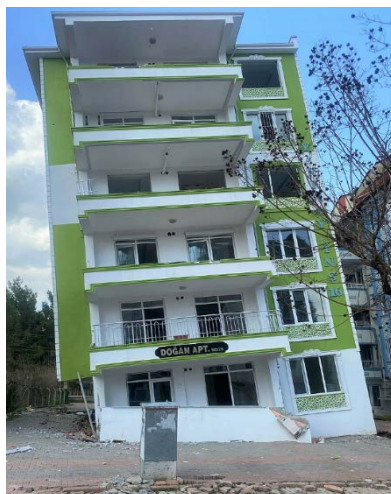
Fig. 5. Clădire înclinată din cauza lichefierii solului
