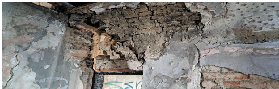
Fig. 10. Dislocări, crăpături și fisuri în pereții de rezistență din zidărie nearmată
