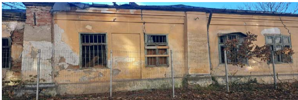
Fig. 12. Crăpături în pereții de zidărie în zona golurilor de uși și ferestre
