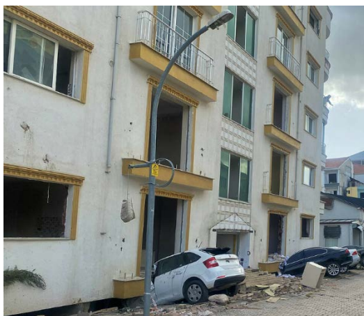
Fig. 10. Colapsul parterului slab al unei clădiri
