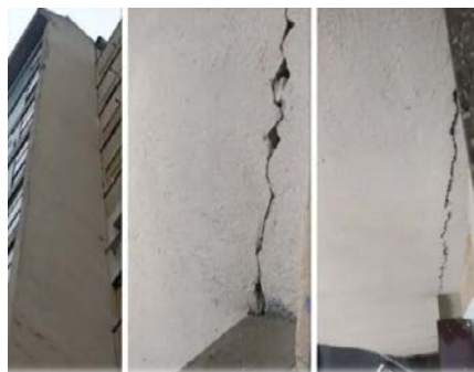
Fig. 3. Fisuri în pereții de beton armat
