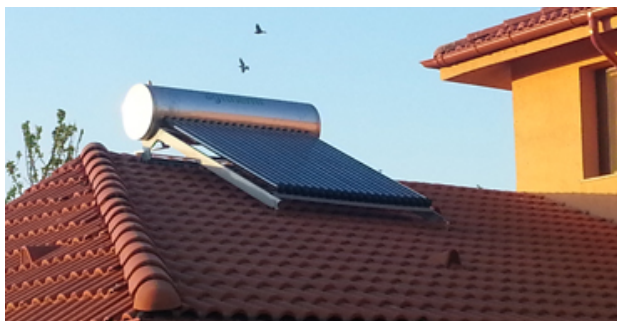
Fig. 1. Panou solar cu boiler montat pe clădire cu acoperiș tip șarpantă
