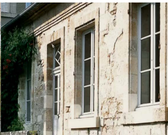
Fig. 2. Fațadă din zidărie afectată de desprinderi locale de tencuială, vegetație necontrolată
