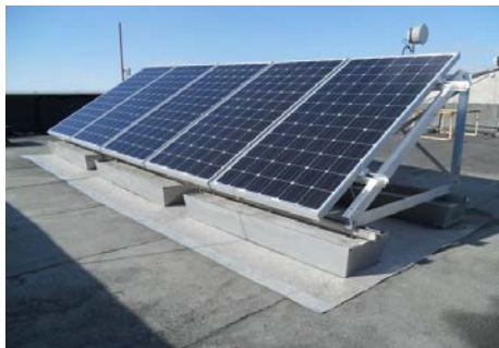
Fig. 2. Panouri fotovoltaice montate pe clădire cu acoperiș tip terasă
