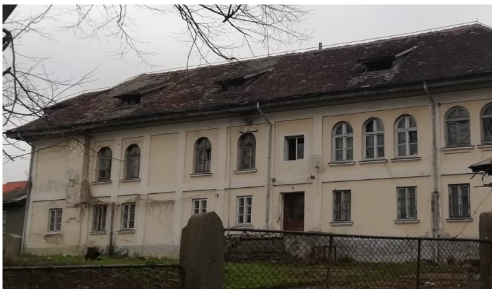
Fig. 5. Aspect exterior fațadă îmbătrânită cu desprinderi de tencuială, șarpantă afectată/ neetanșă.
