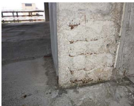
Fig.3 - Lipsa acoperire cu beton și infiltrații
