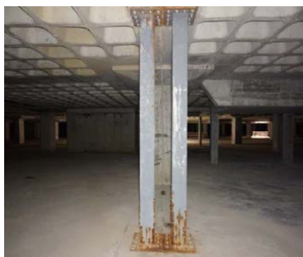
Fig.6 - Coroziune stâlp metalic
