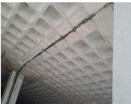
Fig.5 - Degradare rost de dilatare
