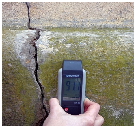
Fig. 1. Fațadă din zidărie afectată de umiditate, microorganisme, mucegai cu evidențierea unei crăpături
