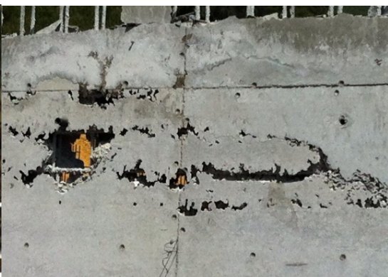
Fig. 4. Aspect exterior – vibrare insuficientă/segregări la elemente din beton armat [13]
