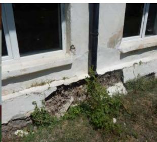
Fig. 9. Aspect exterior desprinderi de fațadă, lipsă trotuar, vegetație necontrolată
