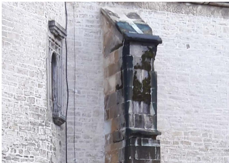
Fig.3. Mănăstirea Cetățuia – umiditatea îndelungată facilitează apariția vegetației
