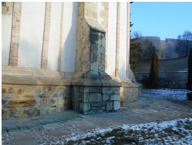
Fig.2 Mănăstirea Bistrița – evacuarea deficitară a apelor pluviale
