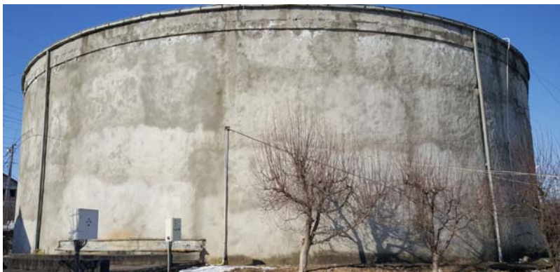
Fig. 1. Rezervor degradat din beton armat
