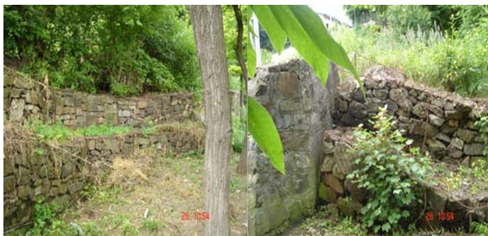
Fig. 1 – Strada Sărărie - Elemente de sprijin – gabioane degradate ca urmare a alunecărilor de teren
