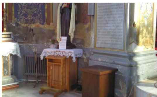
Fig.1. Degradări în urma apariției condensului la soclu
