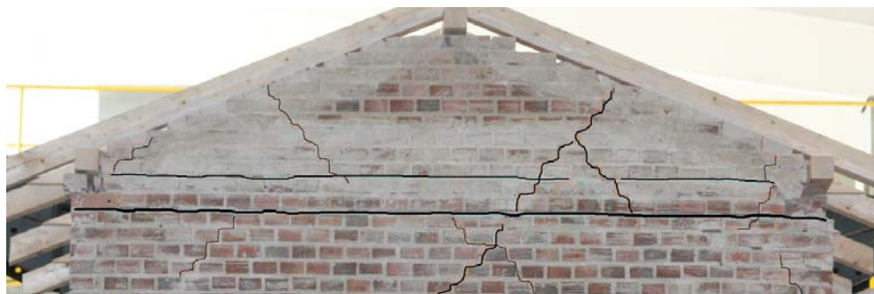
Fig. 12 Degradări apărute la nivelul pereților de fronton
